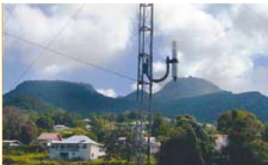
■ Figure IV.74 - Sonde Téléray de nouvelle génération installée à Saint-Claude en Guadeloupe.
